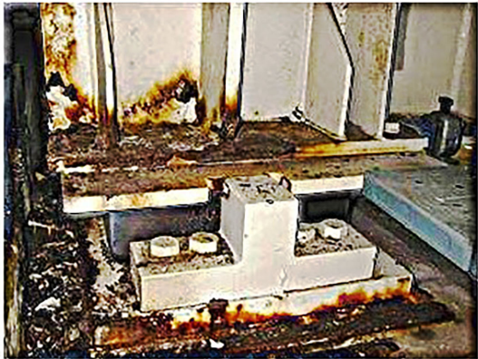
桁端部腐食損傷例
