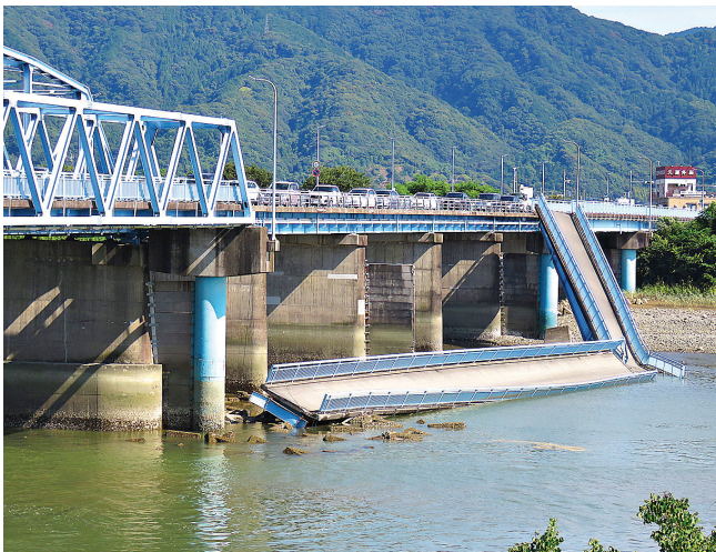
歩道部分が落ちた植柳橋(八代市、7月30日撮影)
