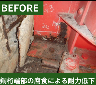
鋼桁端部の腐食による耐力低下
